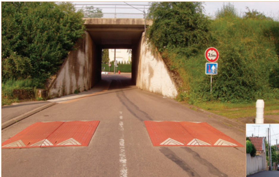
Ralentisseurs situés rue des Mines
